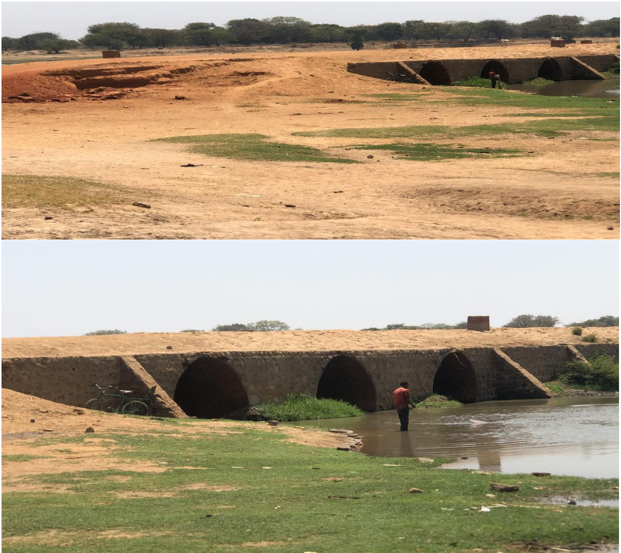
Photo 1 : Pont sur le Mandoul avec un état très dégradé (sur l'axe Bédaya Moïssala). Mars 2023
